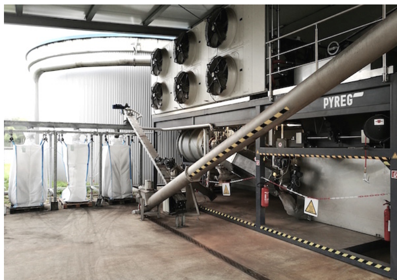
PYREG- Anlage auf der Kläranlage Homburg.
